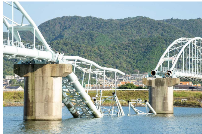
令和3年10月3日に起きた、和歌山市六十谷水管橋落下 出典: 国土交通省 近畿地方整備局HP
