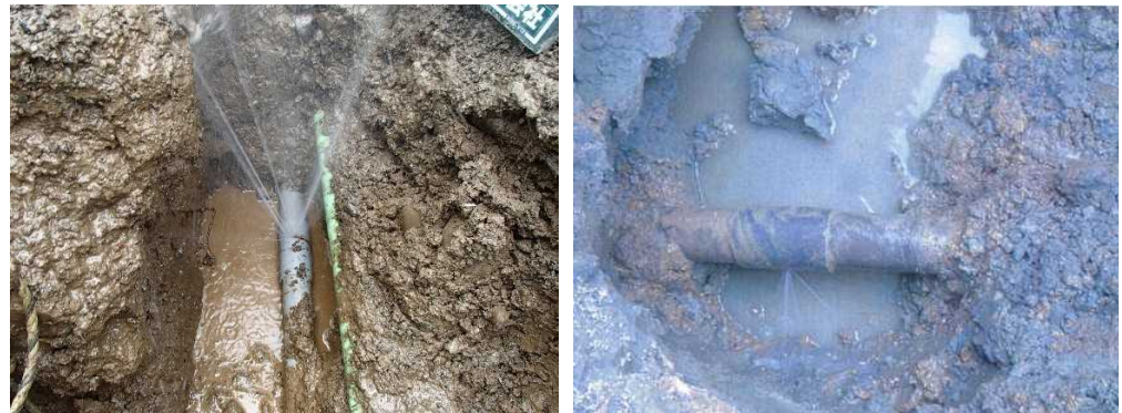
水道管(配水管)の継手部(ジョイント)より漏水している状況
