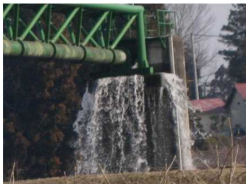
東日本大震災による水管橋の破損 (大崎広域水道) 出典: 厚生労働省
