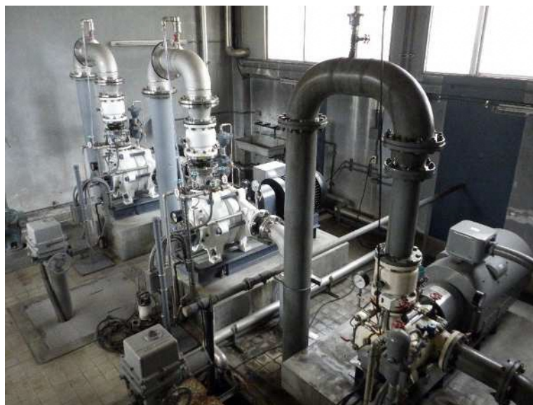
写真 2.9 佐古浄水場配水ポンプ
