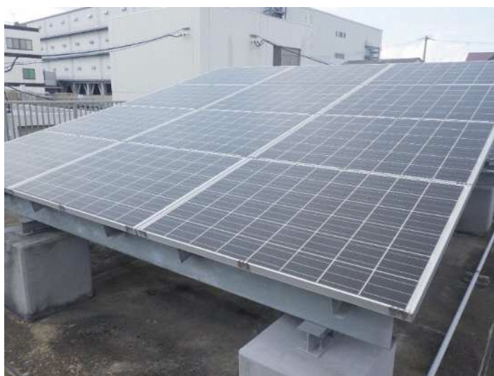
写真 7.1 佐古浄水場の太陽光発電システム
