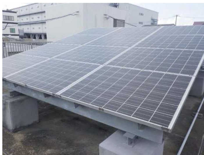
写真 7.1 佐古浄水場の太陽光発電システム
