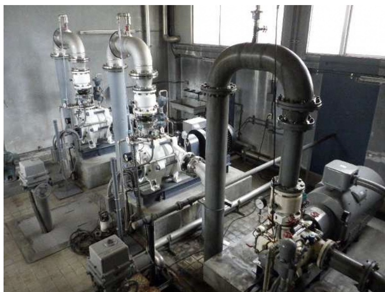
写真 2.9 佐古浄水場配水ポンプ
