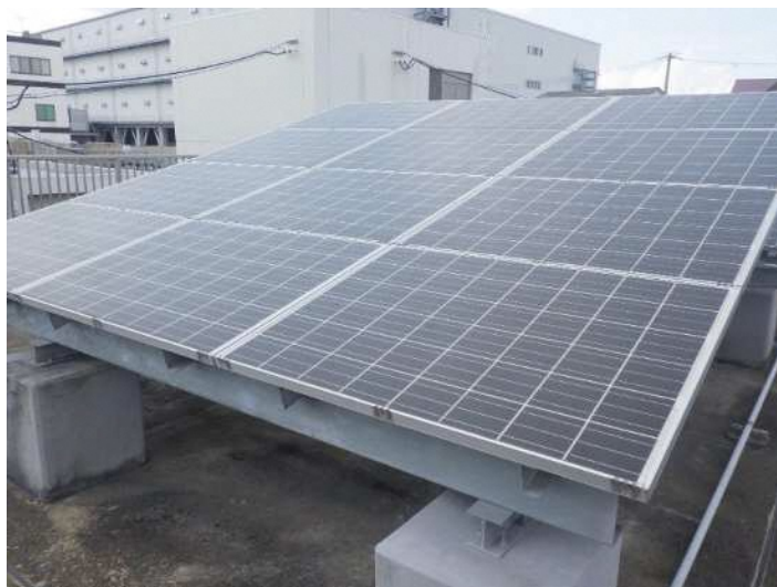
写真 7.1 佐古浄水場の太陽光発電システム
